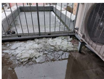
Závada tepelných čerpadel + oprava
